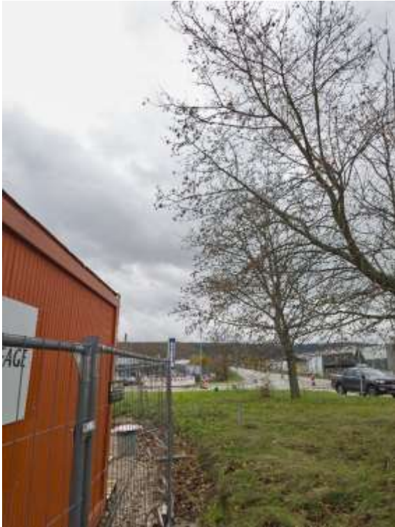
Abbildung 180: Abgrabung im Kronentraufbereich von Baum 661.
